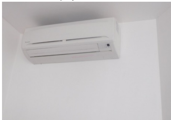
Obr. 47: Nástenné klimatizačné zariadenia skladajúce sa z dvoch a viacerých jednotiek
