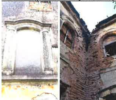
Poškodené časti fasády
