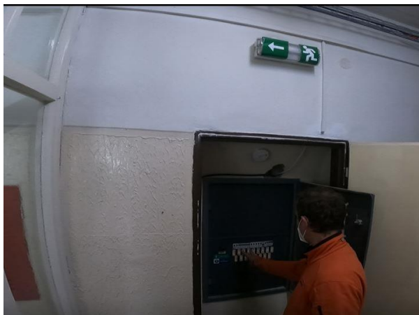
Obr. 35 chodba 1.NP-El. rozvodná skriňa (r. 2021).
