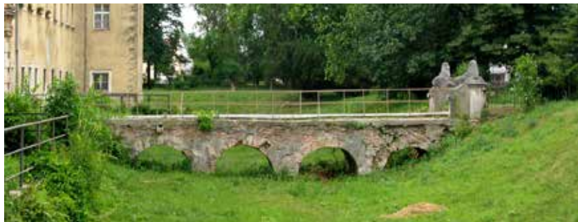
Stupava, okr. Malacky, most pri kaštieli, stav pred obnovou Foto: P. Fratrič, 2003, Archív PÚSR Bratislava
